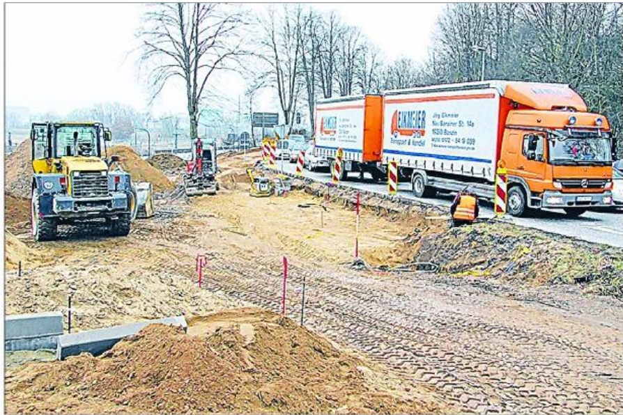
Die Bauarbeiten zur Inbetriebnahme der Behelfsbrücke über den Elbe-Lübeck-Kanal in Lauenburg sind auf beiden Seiten im vollen Gange. Zurzeit werden die Fahrbahnen an den Ufern neu angelegt. Fotos: Timo Jann
