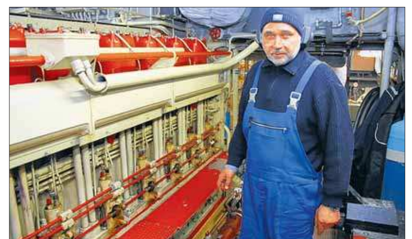
600-PS-Maschine: Laut geht es im Maschinenraum von Horst Reichelt zu.
